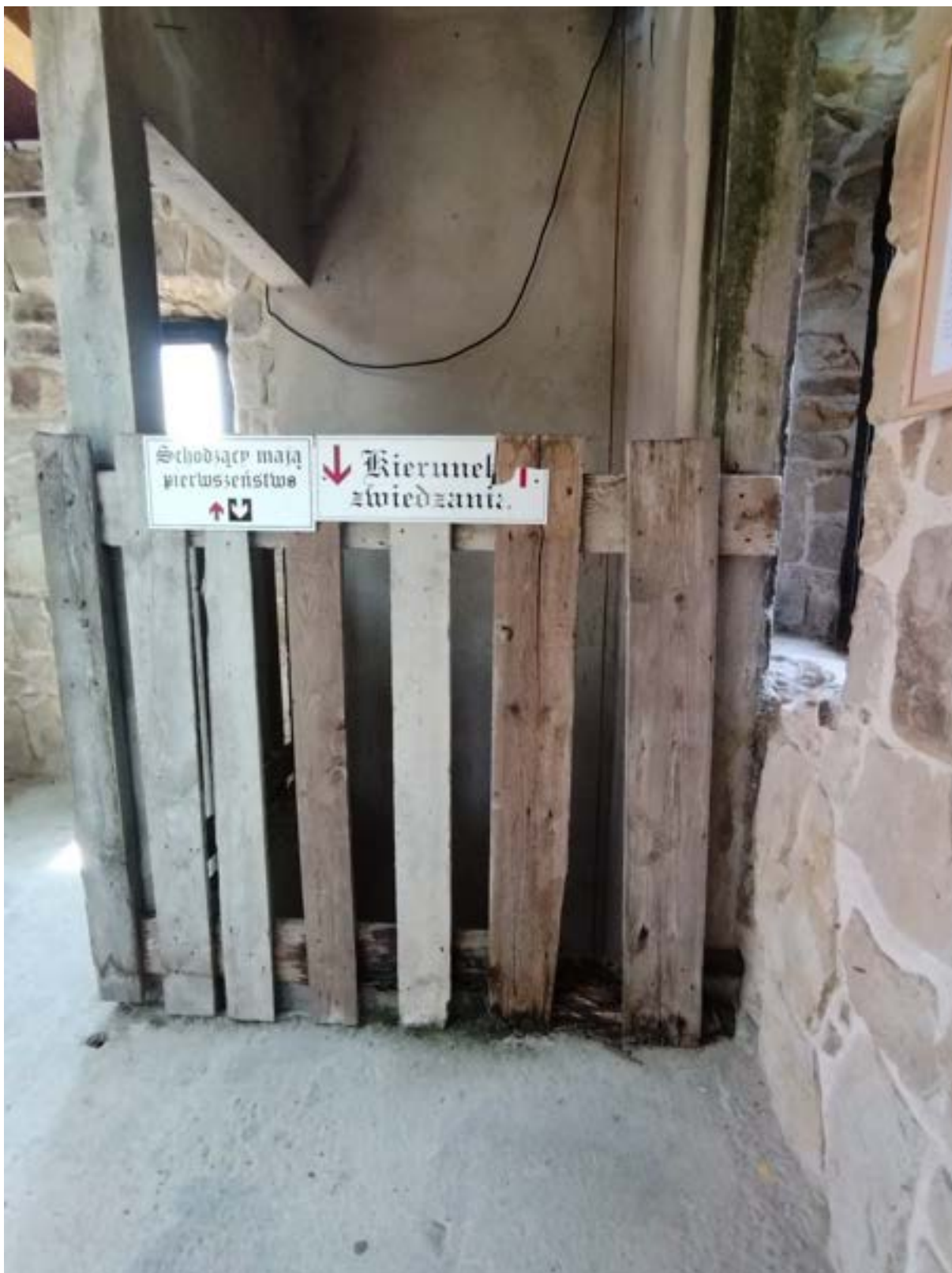
(fot. 121) Nieodpowiednio zabezpieczony szyb windowy w jednej z przestrzeni dedykowanych dla dzieci, wieża zamkowa, zamek Trojsztyn w Wytrzyyszczce, zdjęcie własne, lipiec 2022.
