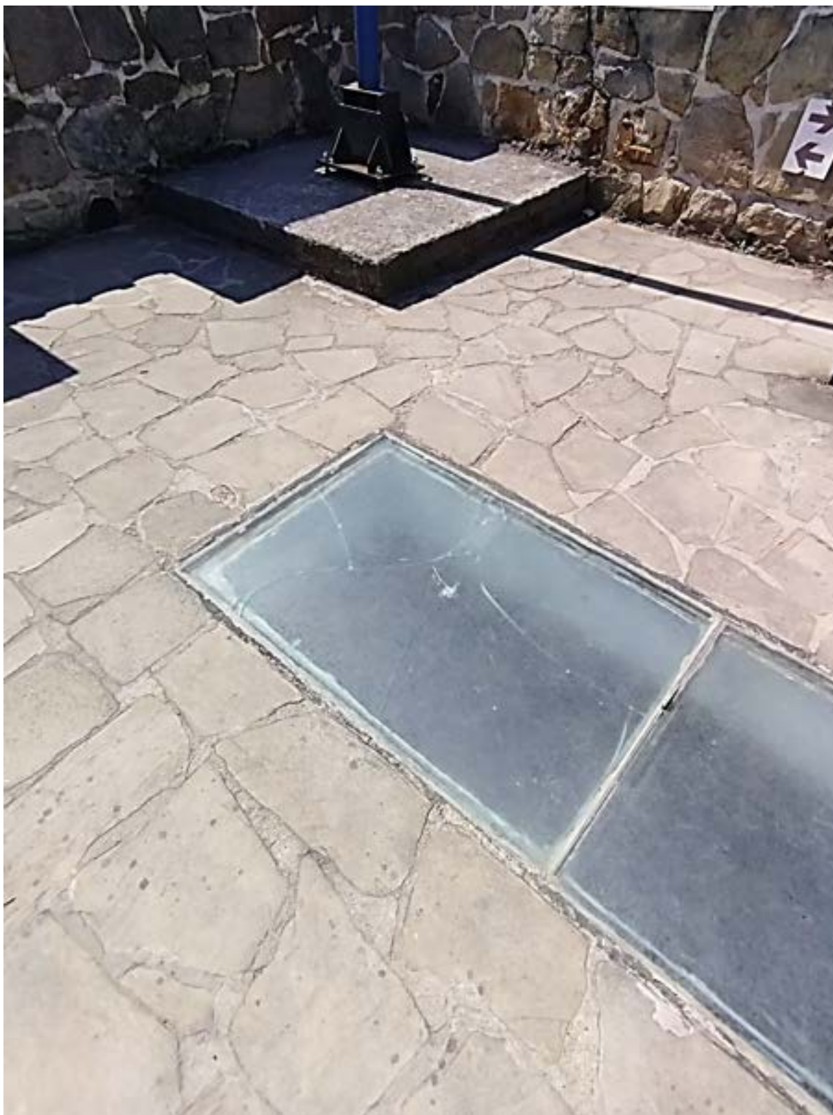
(fot. 124) Uszkodzona szyba podłogowa na tarasie widokowym, zamek Tropsztyn w Wytrzysszce, zdjęcie własne, lipiec 2022.
